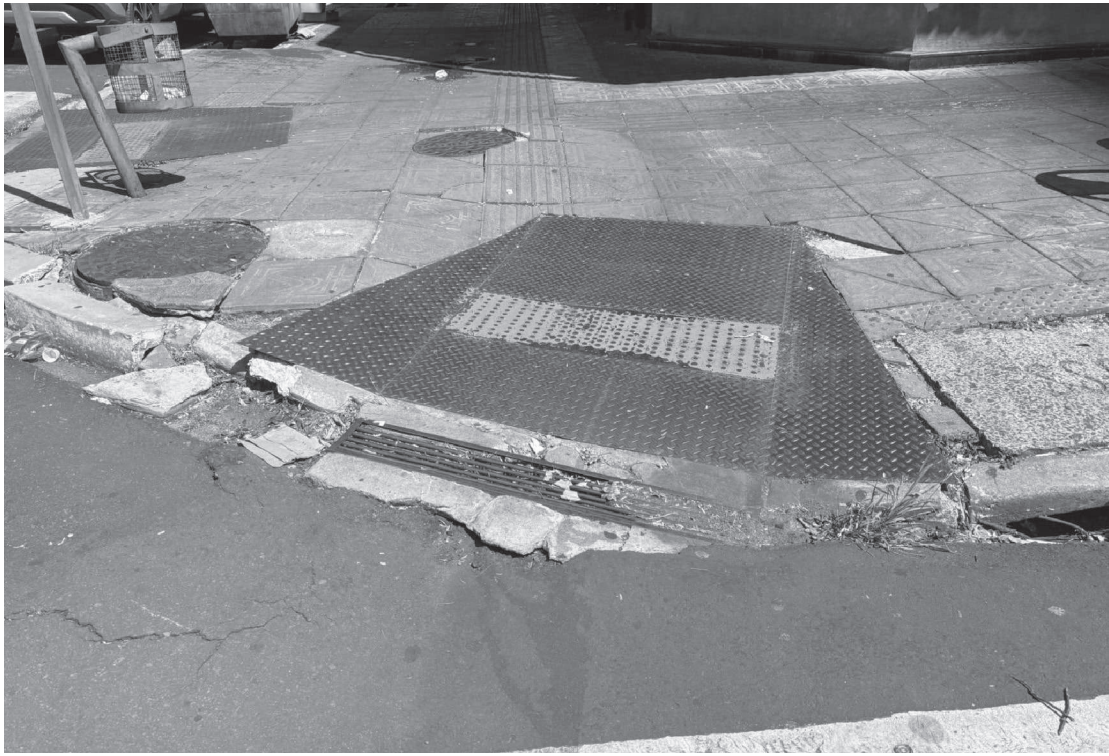
Na Cidade, são encontradas rampas de acessibilidade em estado precário
